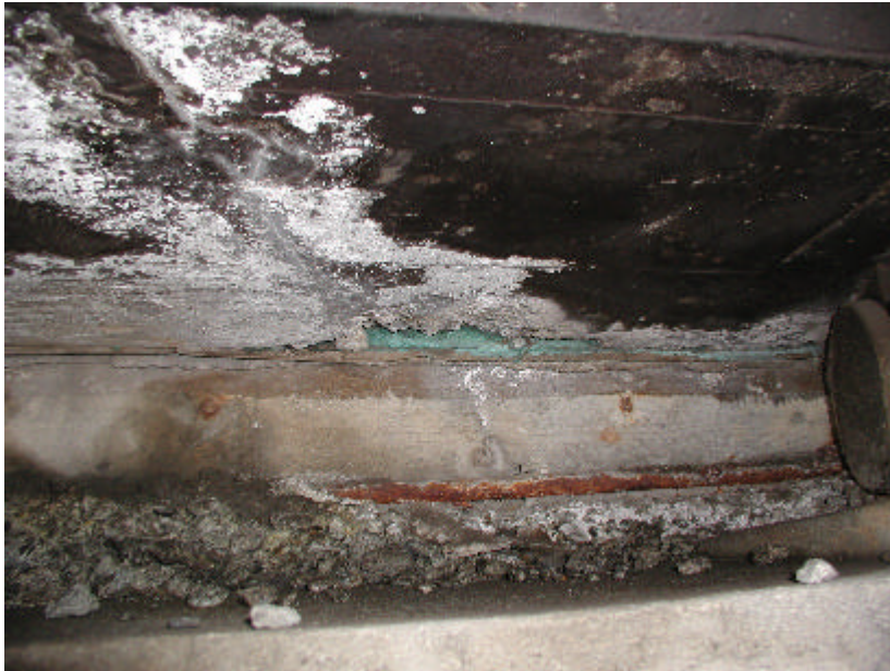
Bild 14 – Widerlager Bundesplatz, Ausblühungen, Beton teilweise zerstört
