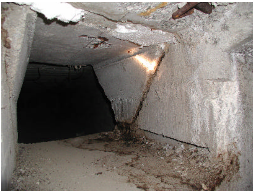
Bild 5 – Kammer D5, Gerbergelenk zu Kammer D6, Fugeneinlagen
