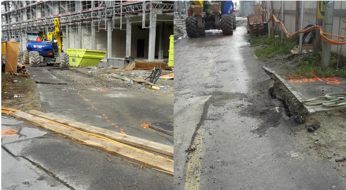
Abbildung 2 Setzungen und Belagsschäden, Aufnahmen vom 09. Januar 2018
