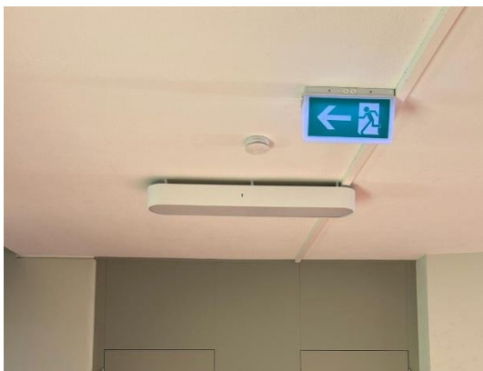
Abbildung 16; Notlicht und Fluchtwegbeleuchtung
